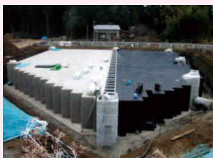
プラスチック貯留槽による空隙貯留浸透施設。 貯留槽や砕石の隙間に水を一時的に貯留し、土中に浸透させていく。
